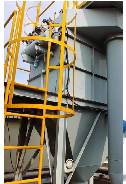
<여과집진시설(백필터) 설치 사진>
