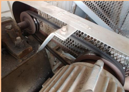
송풍기 - 벨트, 임펠러
